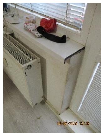
Plastové okná / Radiátor Plávajúca podlaha
