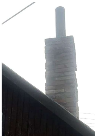
Komín vyžadujúci opravu
