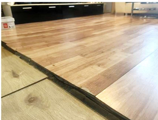
1.NP – opotrebované podlahy
