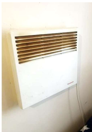
1.NP – elektrické radiátory
