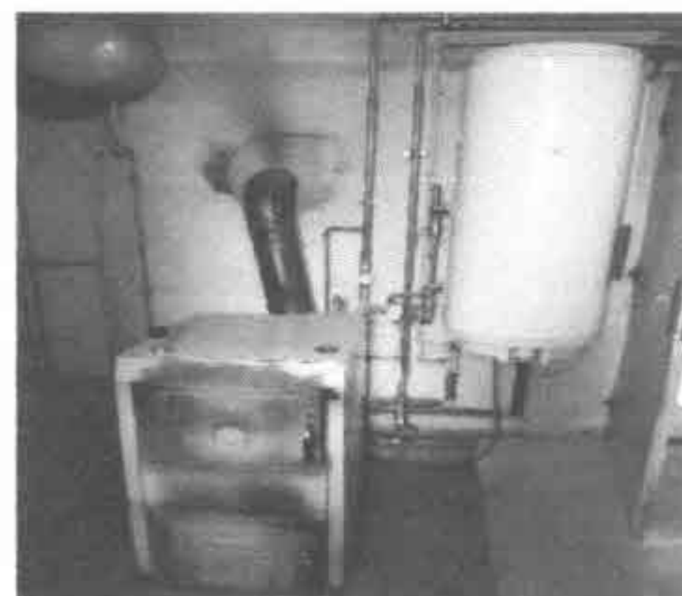
Kotolňa na prízemí
