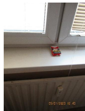
Plastové okná / Radiátor
